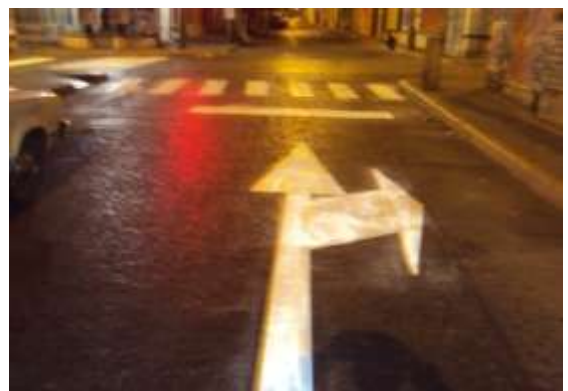
Balizamiento de la calle José Rolon.
