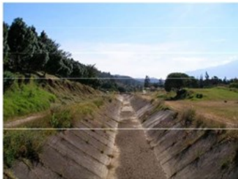
Figura 18. Canal colector de aguas pluviales dentro del parque ecológico “Las Peñas”
