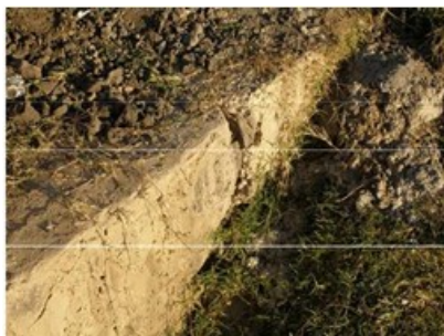
Figura 22. Erosión de los soportes de puentes por alteración de la corriente en las zonas ribereñas y de inundación.
