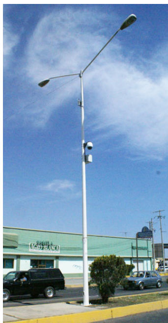
Cámaras de seguridad
